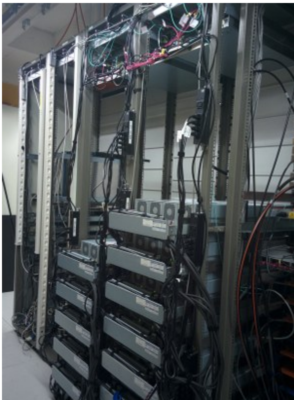
Installation terminée, vue arrière
