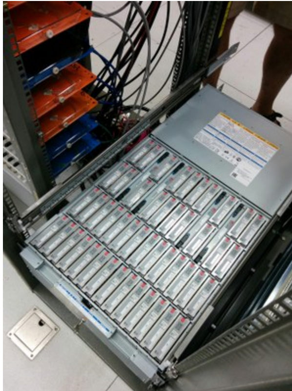
Un des 7 châssis contenant les disques
